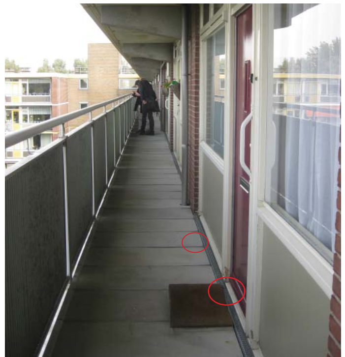
4.14 | Westgevel Beverburgh - locaties houtrot | bron: auteur
