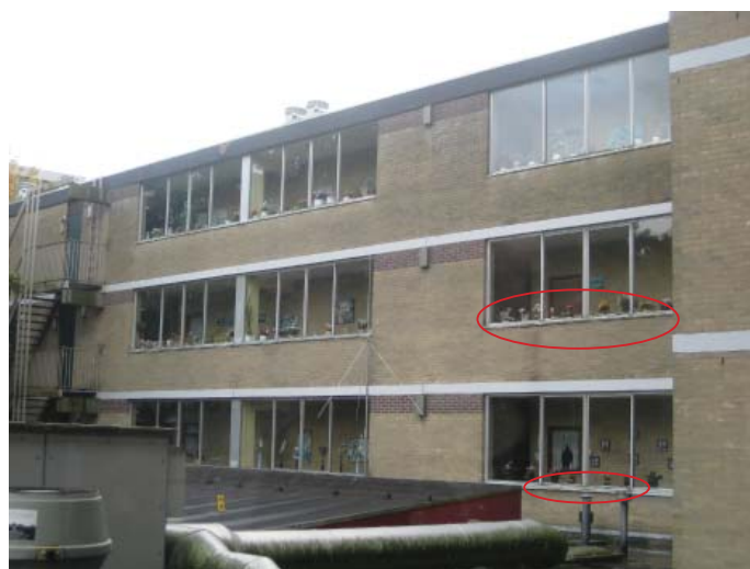
4.12 | Noordgevel Schuilburgh - locaties houtrot | bron: auteur
